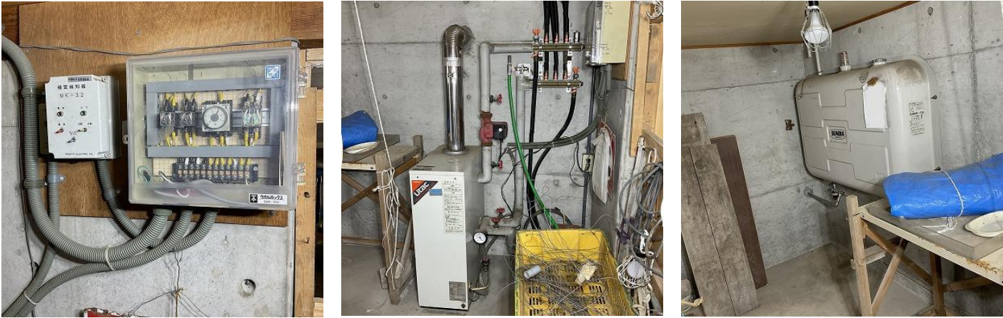
1階(車庫・物置) 屋根融雪装置 ※稼働は点検修繕が必要
