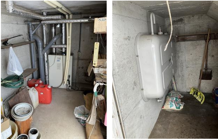
1階(車庫・物置) 給湯設備
