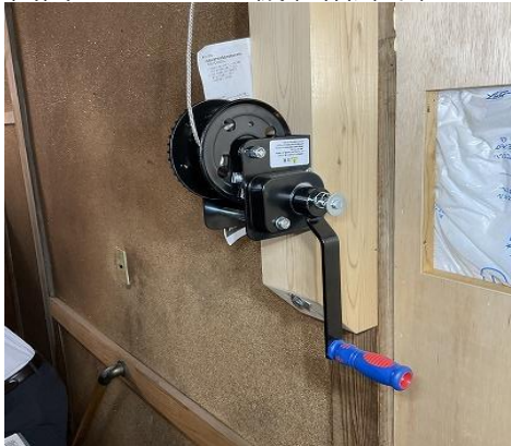
開閉式テラス巻上機(2階廊下)
