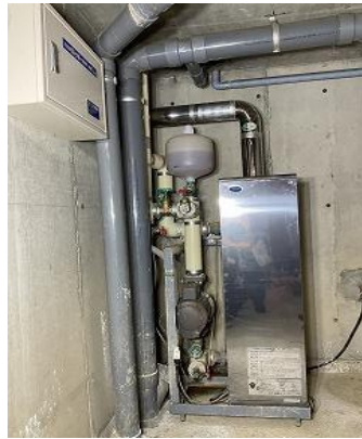
屋根融雪設備
